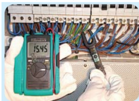
Pomiar prądu w skrzynce rozdzielczej
